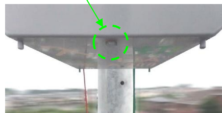
2011 年～2013 年頃製造品 (開閉器を指針側斜め下方から見た様子)
