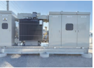
関東某所 A発電所
